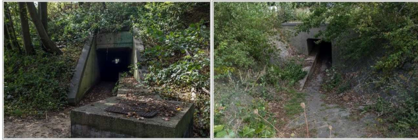
Photo 21 : passage inférieur sous la E411 côté est et côté ouest – (Source : Agora, 2019)
